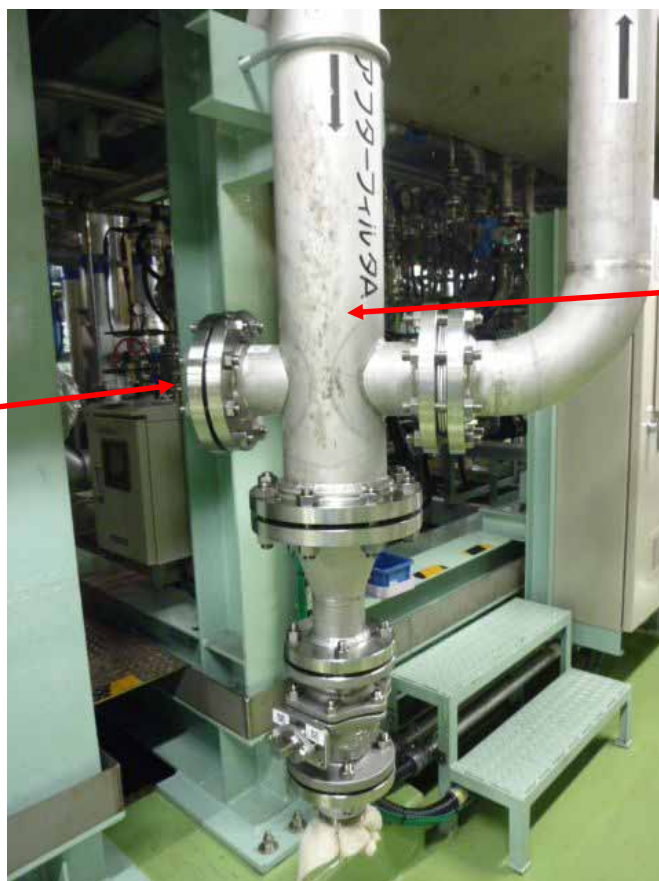
<漏洩した箇所の写真>
